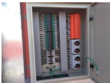
ตู้ฟิวส์/CB ที่ใช้ป้องกันแผงก่อนเข้าอินเวอร์เตอร์
