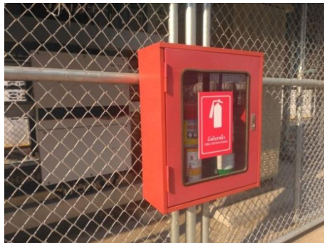
ระบบดับเพลิง
